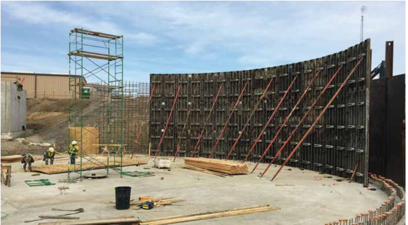
Estação depuradora de águas residuais Stewart Creek, Estados Unidos da América
