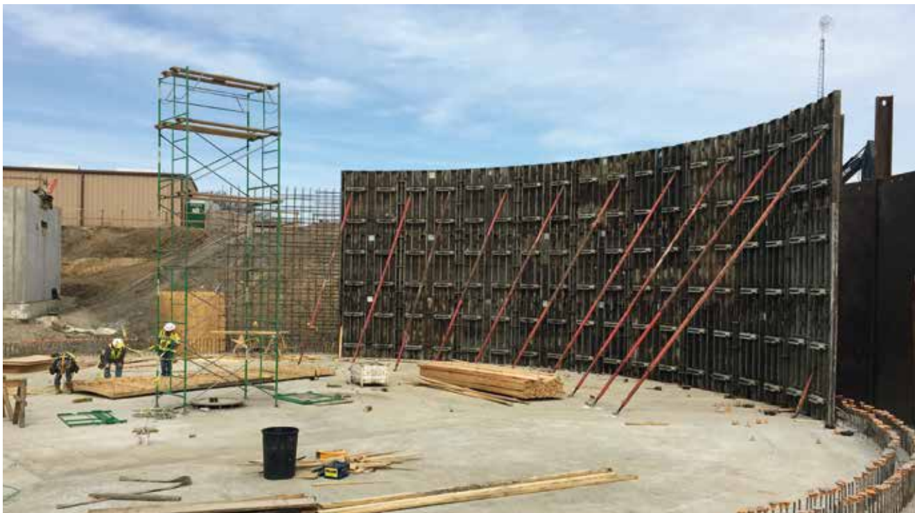
Oczyszczalnia ścieków Stewart Creek, Stany Zjednoczone
