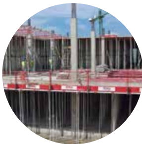
BARANDAS DE SEGURIDAD
